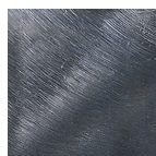
Verniz transparente desgastado
